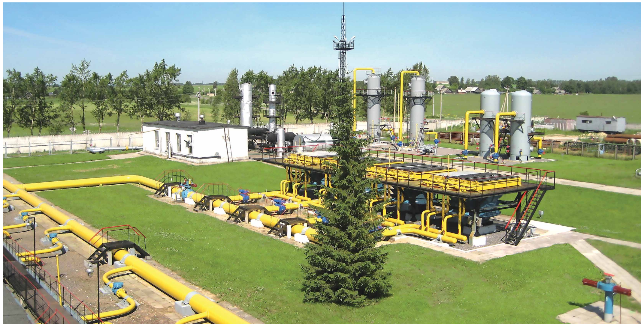
Наземное оборудование Гатчинского ПХГ. Фото из архива Службы по связям с общественностью и СМИ
