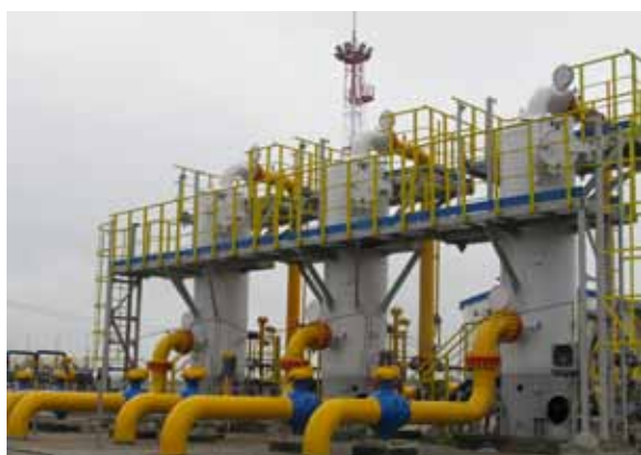
Калининградское подземное хранилище газа
