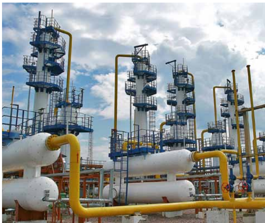
Головные сооружения Невского подземного хранилища газа
